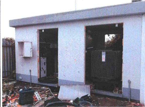
Trafostanica na p.č. 2668/72
