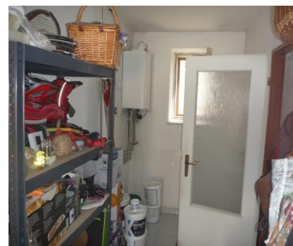
Vstupná chodba v I. NP - pohľad od vstupných dverí - vľavo na stene kotel ÚK
